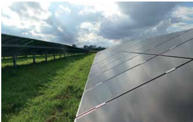
BENG Freiflächenanlage in Aschheim bei München
